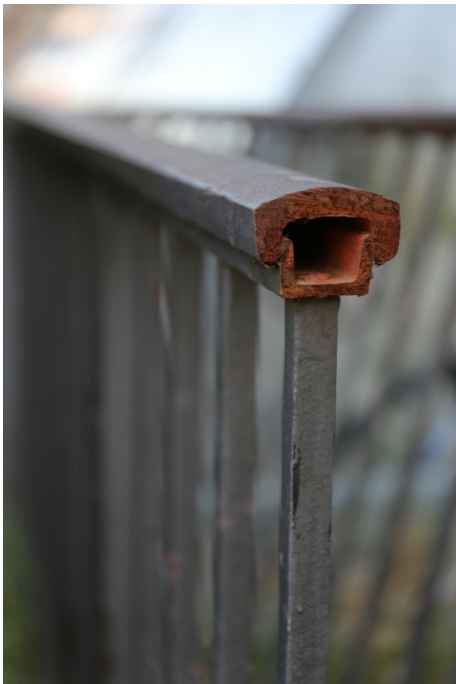
«Seebahneinschnitt», Trasse, Böschungen, Stützmauern und Staketengeländer (261AUSEEBAHN00001), aufgeschnittenes Staketengeländer (Detail) mit oberem und unterem U-Profil, 17.10.2018 (Bild Nr. D101369_65).
