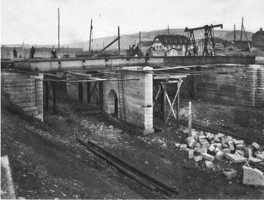
«Seebahneinschnitt», Strassenüberführung Hohlstrasse (261AUSEEBAHN00002) im Bau, Ansicht von W, aus: Denkschrift anlässlich der Eröffnung am 1. März 1927, Abb. 50, 01.01.1927 (Bild Nr. D101369_59).
