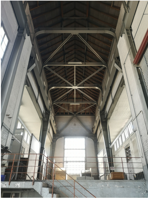
Unterwerk Seebach, Dienstgebäude, Halle gegen O mit Gleis zum Transformatorfeld und dreischiffigem Ostteil für die Umformermaschine, 01.07.2019 (Bild Nr. D101382_09).
