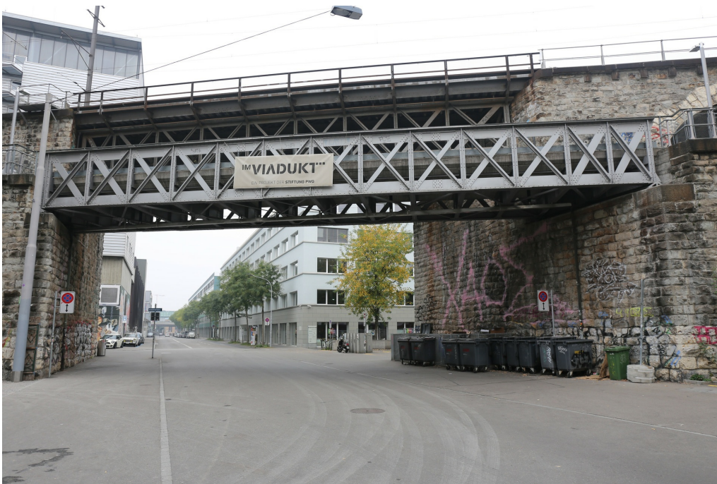
Lettenviadukt, Hausteinbögen und Strassenunterführungen (261AUVIADUKT00002), Strassenunterführung Josefstrasse, Ansicht von SO, 20.10.2018 (Bild Nr. D101138_50).
