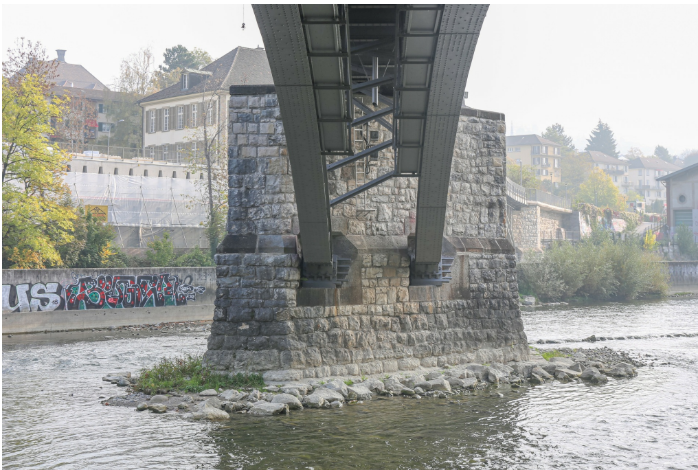
Lettenviadukt, Limmatbrücke (261IQBRUECKE00008), Pfeiler in der Limmat und Untersicht auf die Fachwerkbögen, Ansicht von W, 20.10.2018 (Bild Nr. D101138_60).
