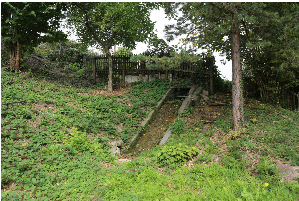
Wipkinger Viadukt, Erddamm Wipkingen mit Entwässerungsanlage (261WPDAMM00002), offener Entwässerungskanal, Ansicht von S, 20.10.2018 (Bild Nr. D101353_88).
