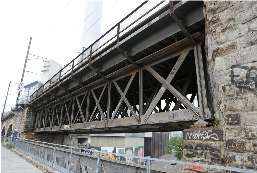
Wipkinger Viadukt, Hausteinbögen mit Strassenunterführungen (261AUVIADUKT00001), Strassenunterführung Josefstrasse, Ansicht vom Lettenviadukt (261AUVIADUKT00002 u. a.), 20.10.2018 (Bild Nr. D101353_70).
