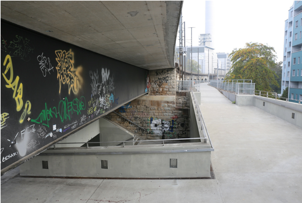
Wipkinger Viadukt, Hausteinbögen mit Strassenunterführungen (261AUVIADUKT00001), ehem. Strassendurchlass Geroldstrasse, heute Aufgang zum Lettenviadukt (261AUVIADUKT00002) mit Treppe und Lift, 20.10.2018 (Bild Nr. D101353_68).
