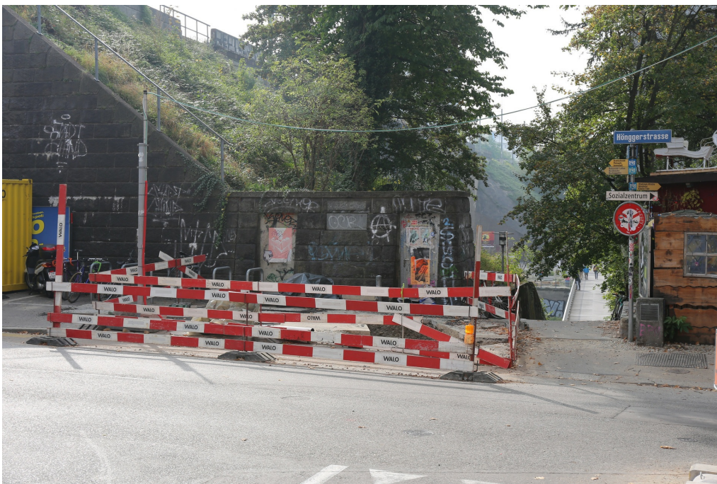
Wipkinger Viadukt, Erddamm Wasserwerkstrasse (261WPDAMM00001) und Pissoir (261WPPISSOIR00001), Ansicht von N, 20.10.2018 (Bild Nr. D101353_86).
