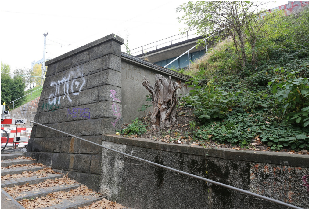
Wipkinger Viadukt, Erddamm Wasserwerkstrasse (261WPDAMM00001) und Pissoir (261WPPISSOIR00001), Ansicht von SW, 20.10.2018 (Bild Nr. D101353_87).
