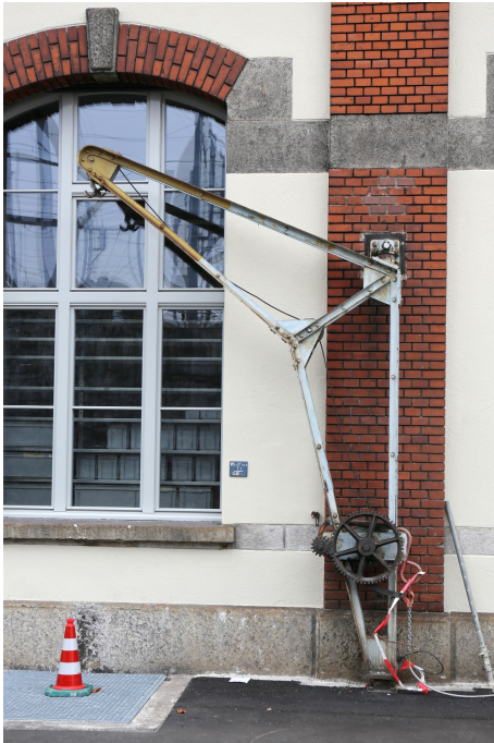
«Depot F», Schwenkhebekran West (261AUKRAN02834-2), 15.12.2018 (Bild Nr. D101139_62).
