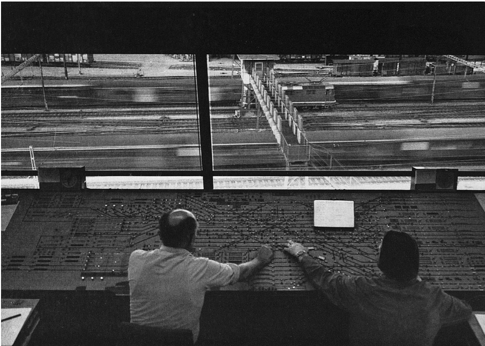
Stellwerke, Zentralstellwerk (261AU00932), Blick aus der Kanzel auf die Gleise, aus: Rita Fischler, Der Bahnhof – eine Stadt für sich, in: Die Schweiz = Suisse = Svizzera = Switzerland, hg. von Schweiz. Verkehrszentrale, Schweizerische Bundesbahnen SBB u. a., 1973, Nr. 11, S. 38., 01.01.1973 (Bild Nr. D101139_42).
