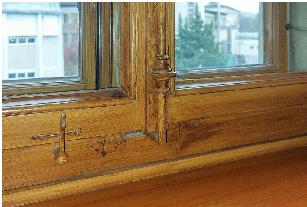
Ehem. eidgenössische Sternwarte, ehem. Sternwarte (261OBSTERNW00001), Nordwestflügel, Detailaufnahme eines bauzeitlichen Fensters, 30.03.2022 (Bild Nr. D104014_40).
