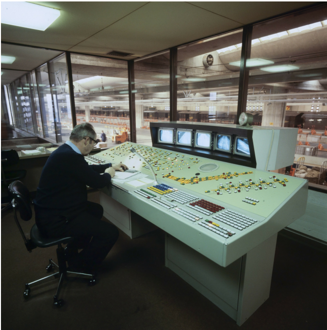
«Schnellgut-Stammbahnhof» Zürich Altstetten, «Schnellguthalle» (261AL00125), Kontrollposten der Fördersysteme in der Halle Januar 1979, Bildarchiv ETH Zürich, Sign. Com_C28-003-006, 01.01.1979 (Bild Nr. D101353_08).
