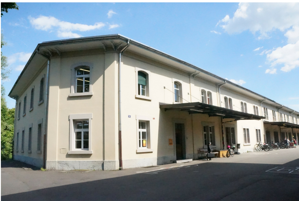
Zeughausareal Nord, Zeughaus Ost, ehem. Zeughäuser 2 BB und 3 BC (230MA02644), Ansicht von NW, 19.05.2014 (Bild Nr. D100632_12).
