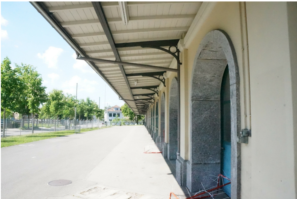
Zeughausareal Nord, Zeughaus West, ehem. Zeughaus 1 BA und Abwartswohnung (230MA01908), Westfassade mit Dachuntersicht, Ansicht von SW, 19.05.2014 (Bild Nr. D100632_06).
