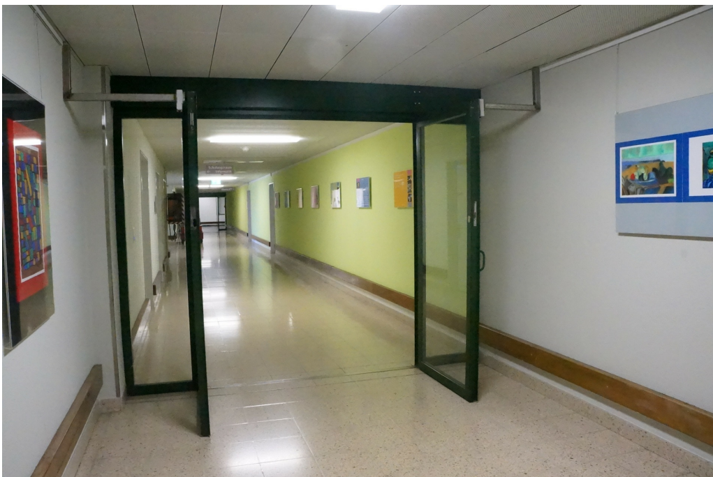
Klinik Schlosstal, ehem. Spinnerei Beugger, Erweiterungstrakt (230WUERWEIT00571), bauzeitliche Tür zum Verbindungsgang zur nordwestlichen Erweiterung im UG, bauzeitlicher Bodenbelag, 10.06.2014 (Bild Nr. D100648_26).
