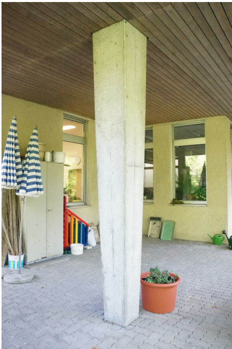
Klinik Schlosstal, ehem. Spinnerei Beugger, Erweiterungstrakt (230WUERWEIT00571), sich gegen unten verjüngende Betonstütze und bauzeitlich erhaltene Dachuntersicht im Innenhof, 10.06.2014 (Bild Nr. D100648_18).
