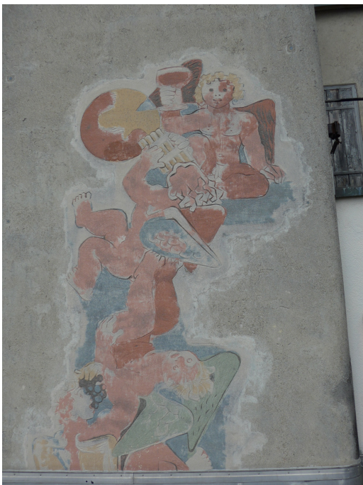
Weinkellerei, Lagergebäude, Aufzugturm im SO, Wandbild «Weinlese» von Heinrich Daniöth (Ausschnitt), 18.08.2015 (Bild Nr. D101066_06).
