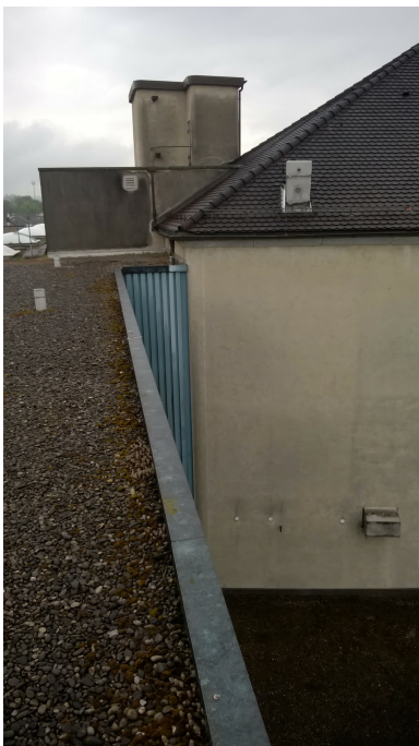
Weinkellerei, Baunaht zwischen Erweiterung (I.) und dem Lagergebäude, 18.08.2015 (Bild Nr. D101066_13).
