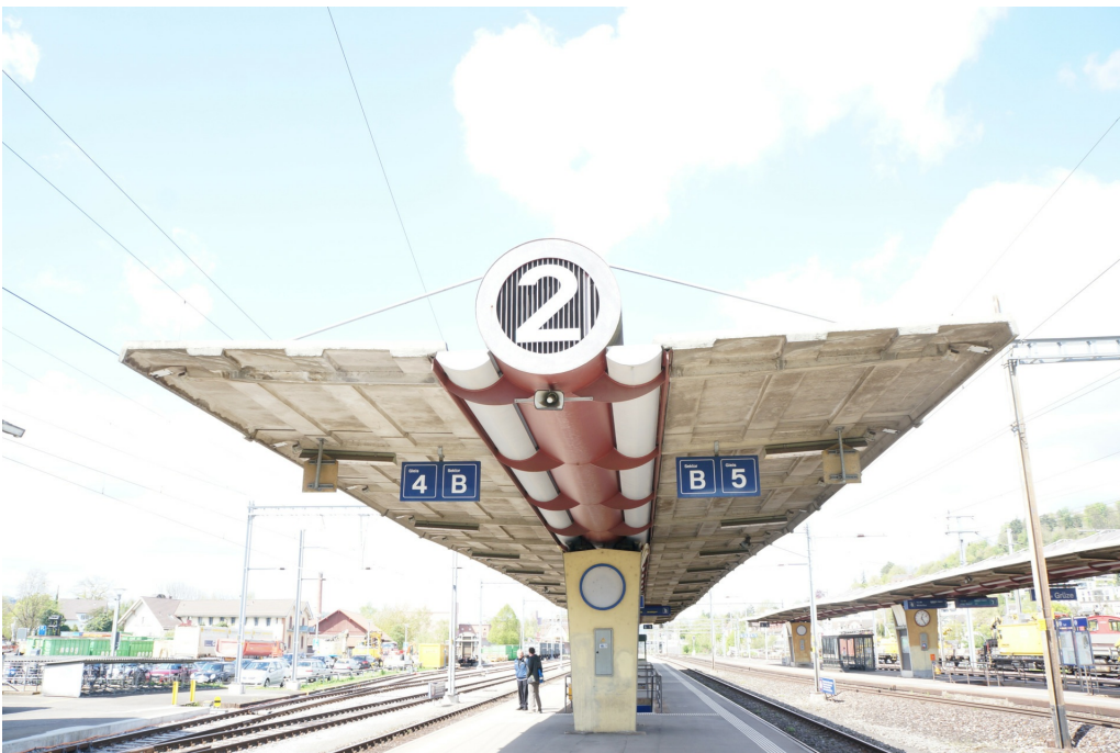
Bahnhof Winterthur Grüze, Perrondächer, südwestliches Perrondach mit Perronnummer am Rohrträger, Ansicht von SO, 15.04.2014 (Bild Nr. D100608_45).
