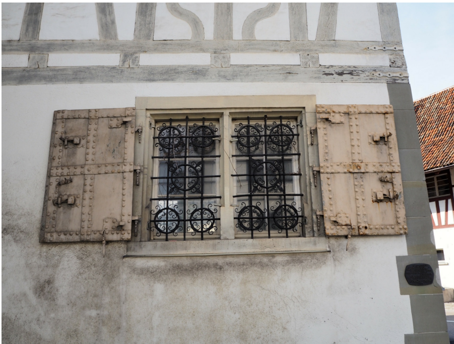
«Wespimühle», Mühlegebäude mit Büro- und Gewerberäumen und Turbinenhaus (230WU00581), Kontoranbau, Fenster im EG der Südostfassade, 06.04.2017 (Bild Nr. D100650_20).
