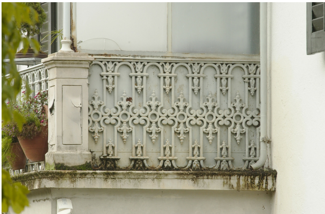
Landsitz «Rosenberg», Ensemble ehem. Villa Bidermann, ehem. Villa Bidermann (230ST00551), Veranda auf der Südwestseite, Geländer (Detail), 04.09.2001 (Bild Nr. D100212_10).
