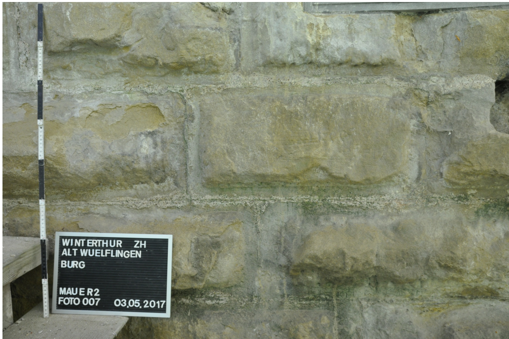
Burgruine Alt-Wülflingen, Nordostfassade (Detail), Fugenstrich teilweise mit roter Bemalung, 01.01.2017 (Bild Nr. D101137_31).
