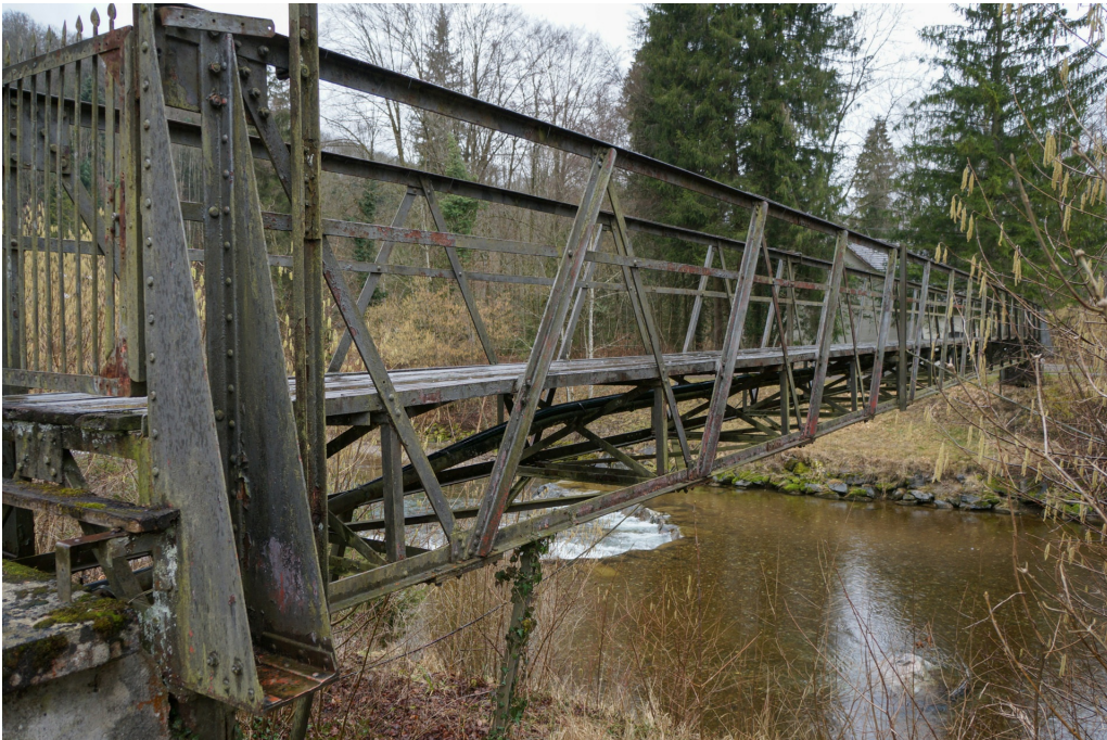
Wasserbauten und Wasserkraftanlagen der ehem. Spinnerei Bühler, Dienststeg (296STEG00002, 230MASTEG00001), Ansicht von NO, 23.02.2016 (Bild Nr. D100605_64).
