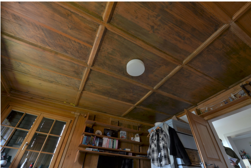
Ref. Pfarrhaus, Zimmer im 2. OG, Kassettendecke, Blick nach N, 06.10.2021 (Bild Nr. D102609_33).
