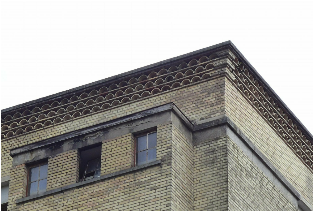
«Maggi-Areal», Betriebsbauten, Würzefabrik mit Garagenanbau/Feuerwehrdepot (Vers. Nr. 01208); Würzefabrik, Kranzgesims der Nordwestecke (Detail), 29.08.2016 (Bild Nr. D101150_27).
