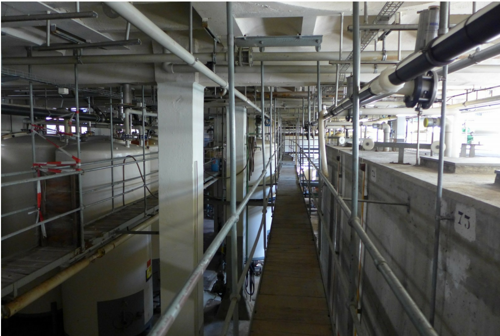
«Maggi-Areal», Betriebsbauten, Würzefabrik mit Garagenanbau/Feuerwehrdepot (Vers. Nr. 01208); Würzefabrik, UG mit Hängebrücken und Würzesilos, 29.08.2016 (Bild Nr. D101150_32).
