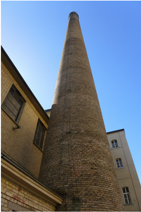
«Maggi-Areal», Betriebsbauten, Maschinen- und Lagerhaus, Kesselhaus mit Hochkamin, Speisesaalanbau und Lokremise (Vers. Nr. 01203); Hochkamin, 29.08.2016 (Bild Nr. D101150_15).
